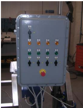
Pannello di controllo / Control Panel
